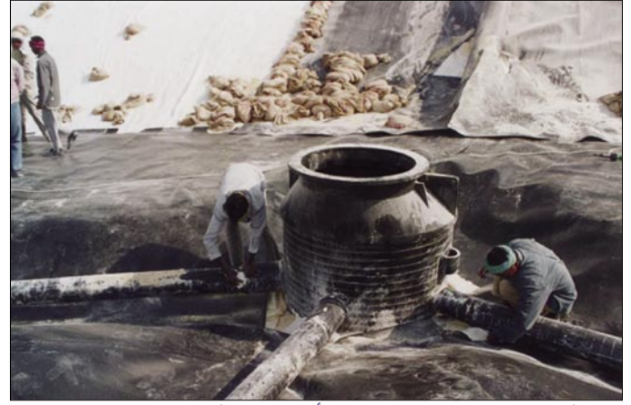
■ فتحة جمع الترشحات (Manhole) و الأنابيب المتصلة بها.
